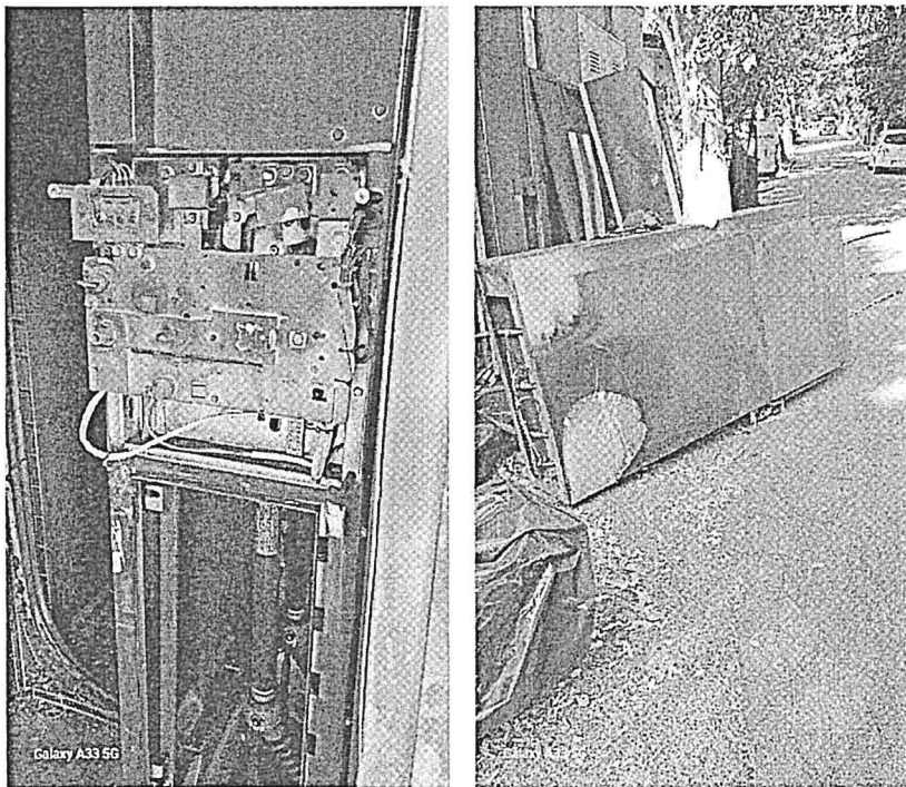
Foto 7-8: Cella MT danneggiata all'interno del vano e appena portata fuori
